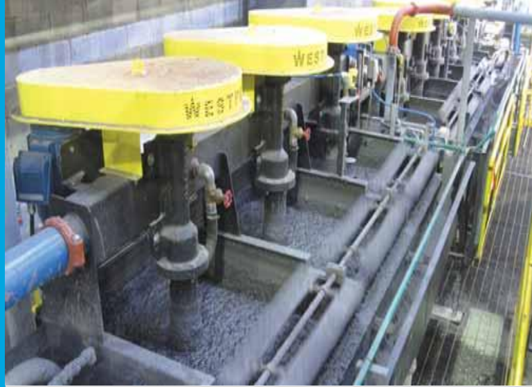
Mantenimiento de Celdas
